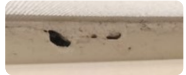
経年劣化による破損や汚れ
